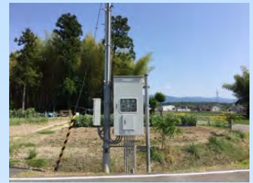
池ノ端MHポンプ盤 (阿賀野川流域)
