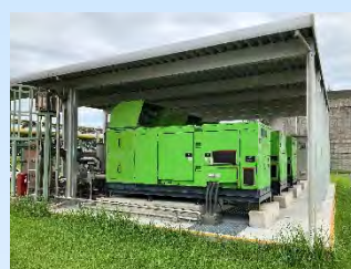
消化ガス発電設備
